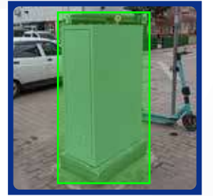
Telekom, Doğalgaz Kutusu Tespitleri
